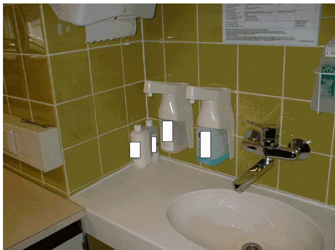
Beispiel eines Händewaschplatzes (Hinweis: Auswahl zufällig; auch vergleichbare Desinfektionsmittelspender und Einhebelarmaturen sind geeignet).
